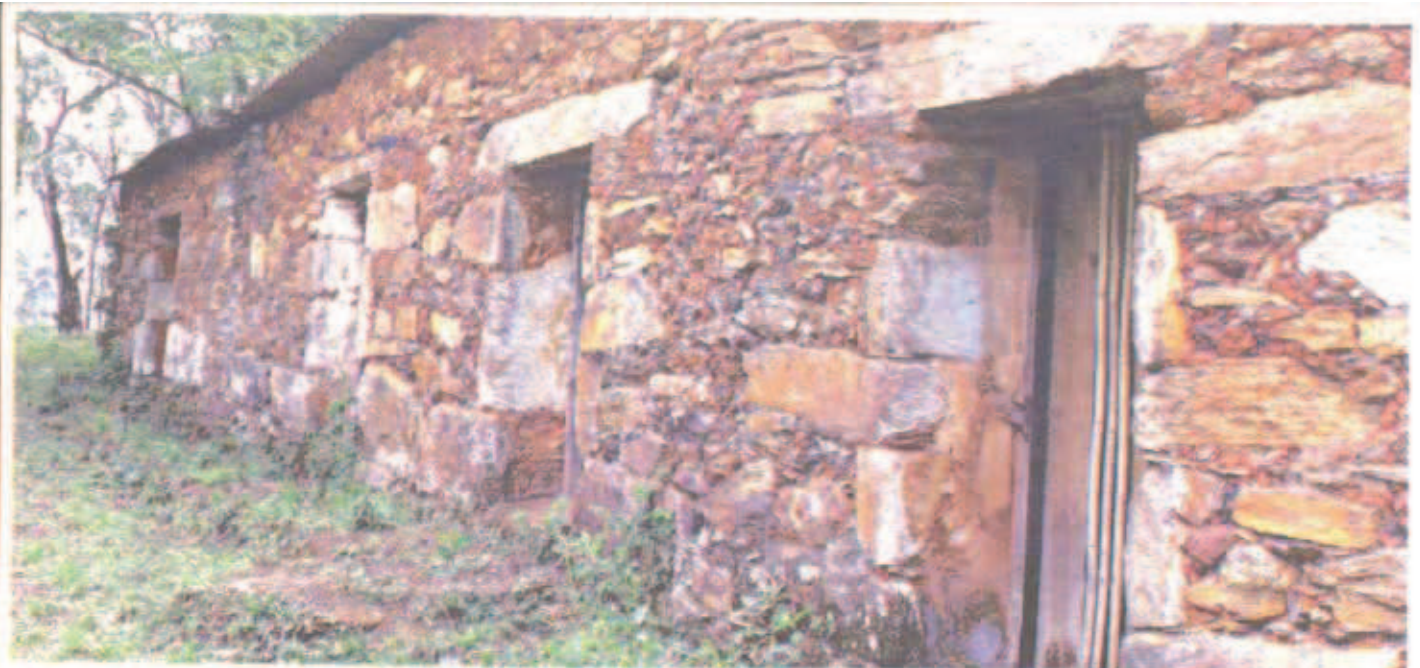
DESCARACTERIZAÇÃO – Construção de pedras recebeu telhado de amianto de uma construtora, que queria montar escritório no local
